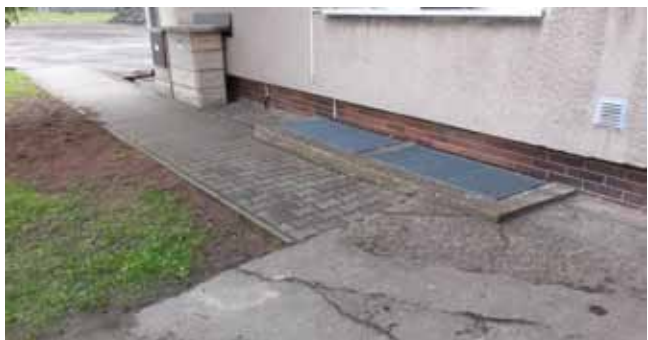
Chodník u OÚ - před opravou
