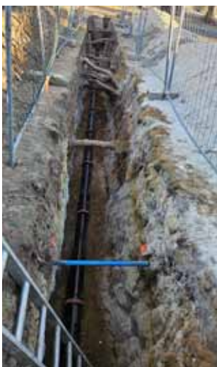
Kanalizační přípojka k č.p. 3 vedoucí přes kořenový systém
