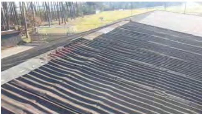
Střecha Restaurace - stav před opravou
