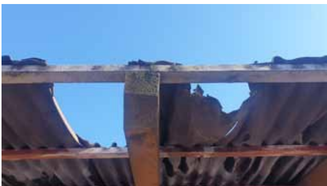
Střecha Pergola - stav před opravou
